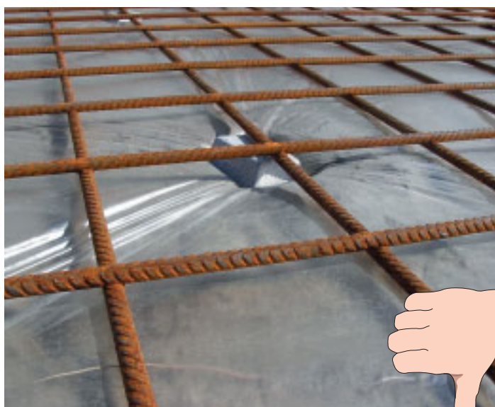
Het tofje is gedeeltelijk in de ondergrond met folie gezakt.
