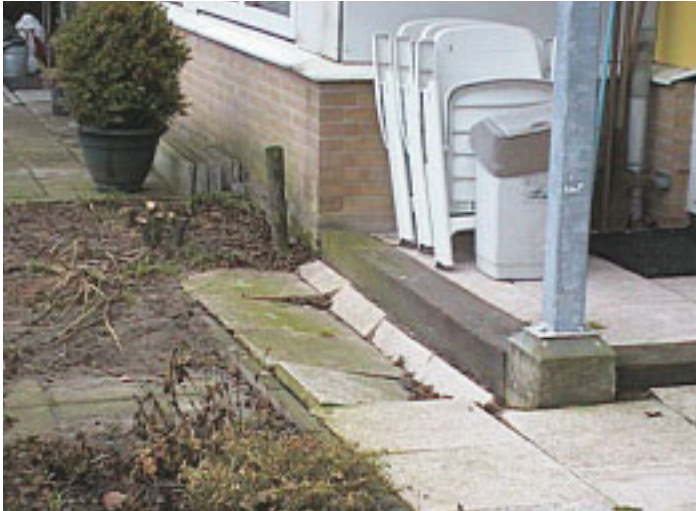
Verzakkingen zijn in versterkte mate aanwezig langs de bebouwing.
